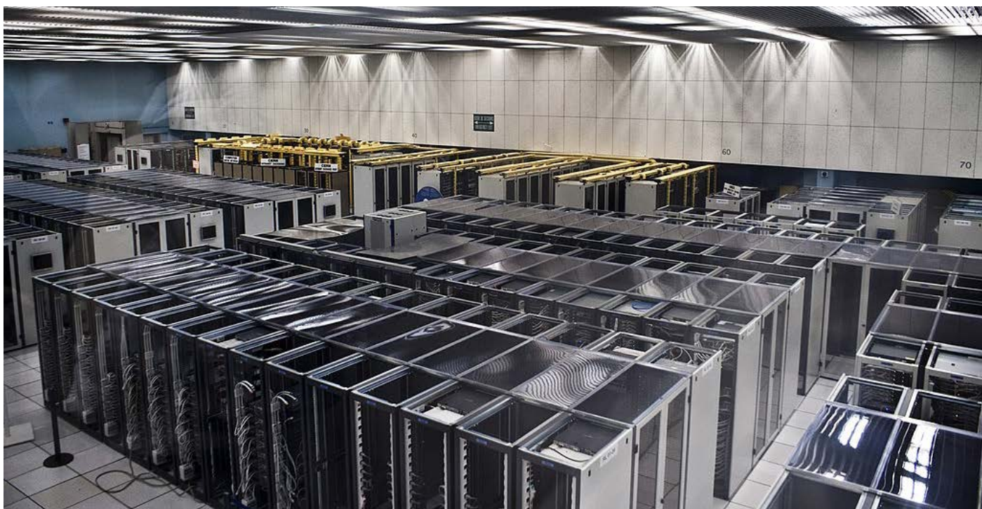
Serveurs du CERN
